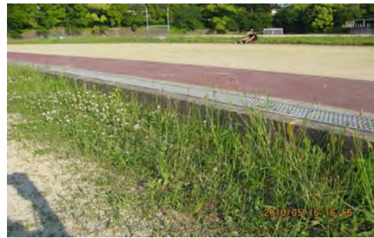
(改善前の段差の様子)
